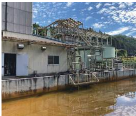
河守鉱山の廃水管理プラント
